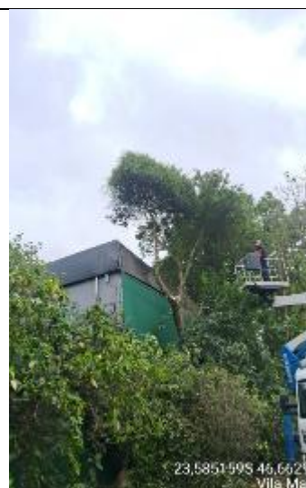
Figura 93: Poda de galhos sobre o vizinho
