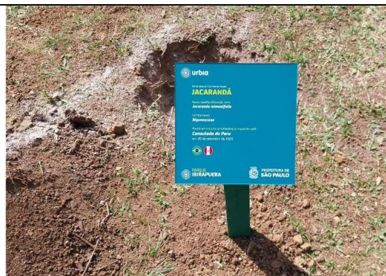
Figura 185: Instalações de Placas
