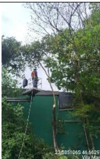
Figura 94: Poda de galhos sobre o vizinho
