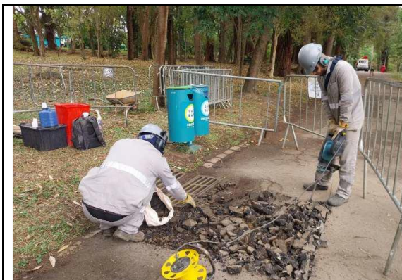
Figura 172: Manutenção de pisos e acessos
